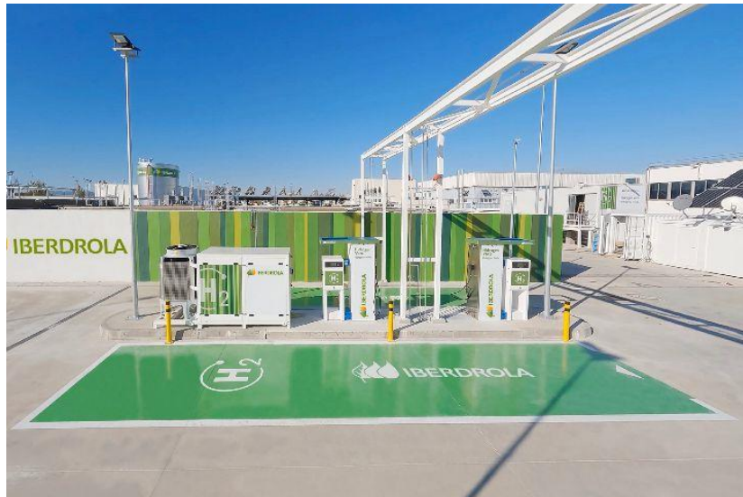
Ilustración 2. Hidrogenera en Zona Franca de Barcelona, primera instalación comercial de producción y dispensación de hidrógeno renovable en España. (Iberdrola, 2023)
