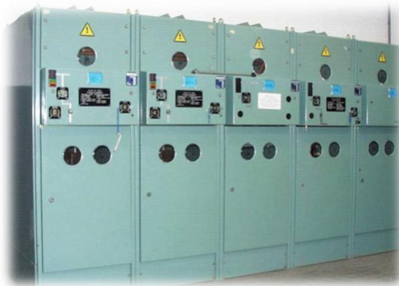
Ilustración 5: Celdas MT corte/aislamiento al aire
