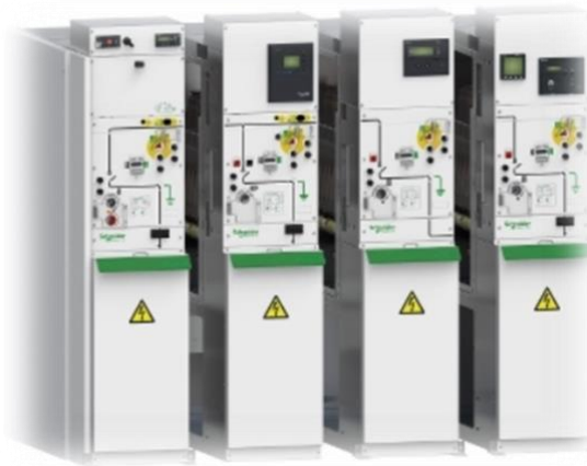
Ilustración 7: Celdas MT extensibles.
