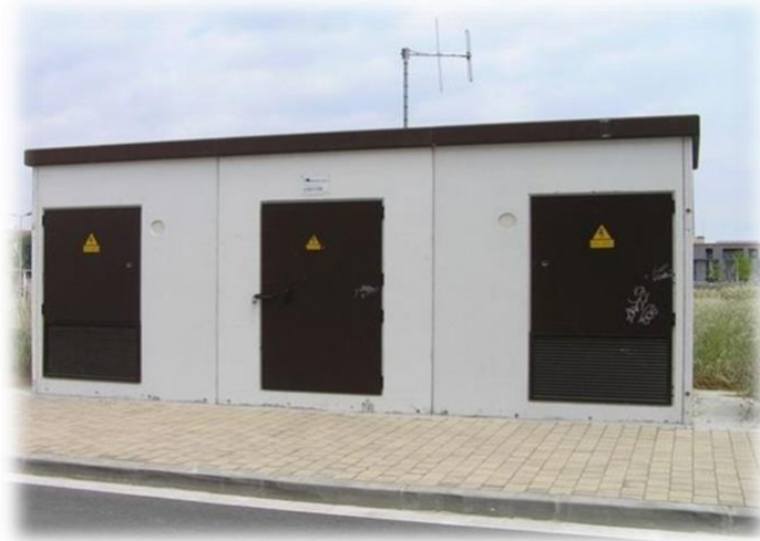
Ilustración 12: CT prefabricado hormigón.
