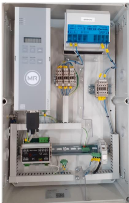
Ilustración 45: Interior Cajón de Control.
