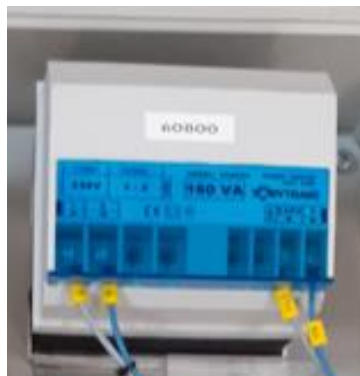
Ilustración 50: Trafo aislamiento OLTC.
