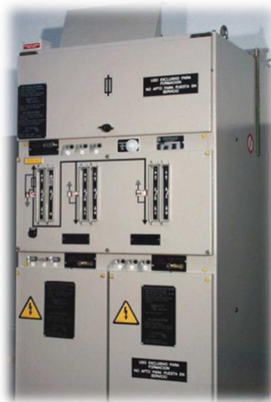
Ilustración 8: Celdas MT no extensibles.
