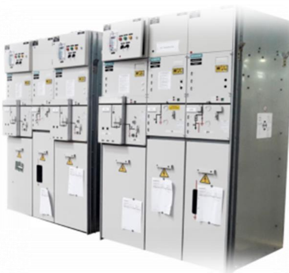
Ilustración 6: Celdas MT corte/aislamiento SF 6
