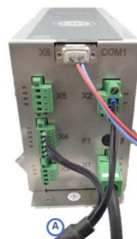
Ilustración 47: Conexiones Unidad Control OLTC
