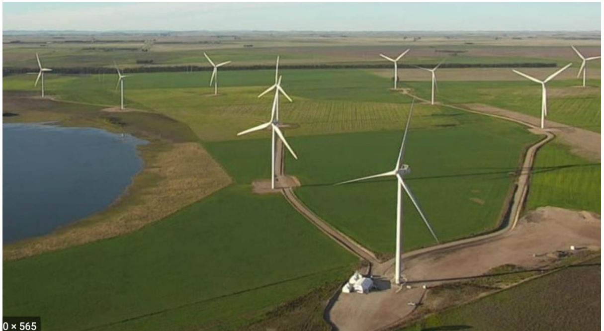
Figura 34: Central eólica onshore. Fuente: Curso 2021-2022 Energías Renovables.
