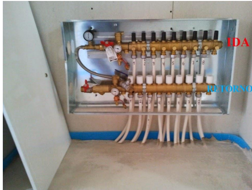
Ilustración 29.- Colectores de suelo radiante.
