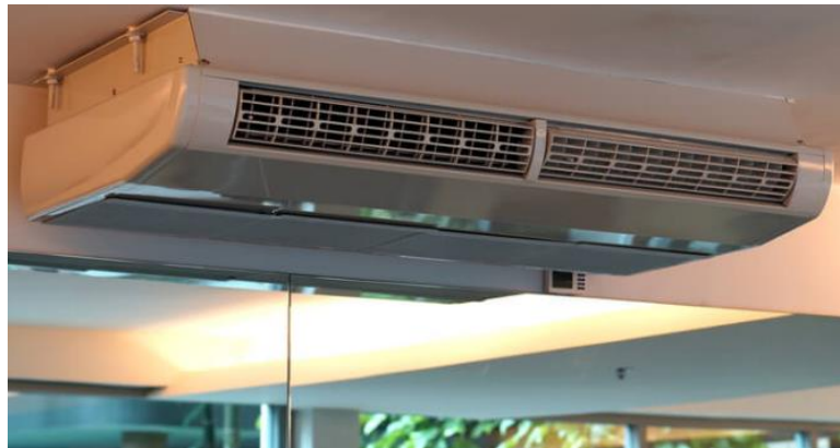
Ilustración 33.- Fan-coil de techo visto.
