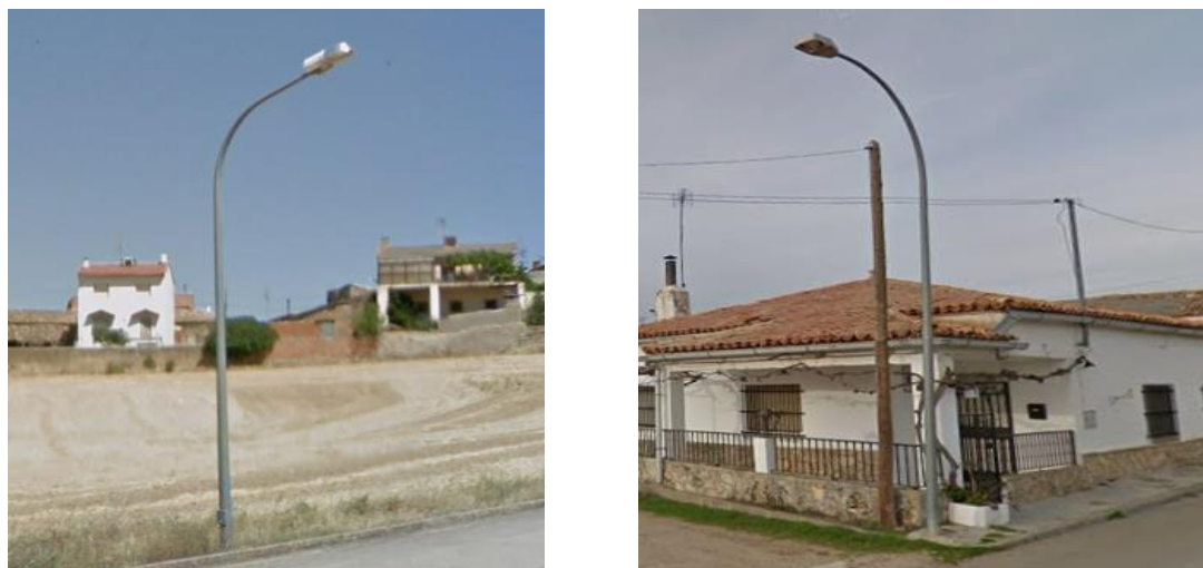
Ilustración 41: Báculos convencionales de acero laminado. Fuente: (Elaboración Propia)
