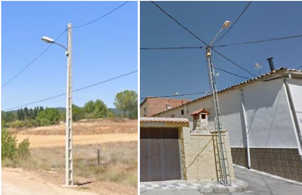
Ilustración 39: Columnas convencionales hormigón prefabricado a la izquierda, metálica a la derecha. Fuente: (Elaboración Propia)
