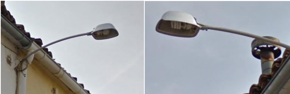
Ilustración 43: Luminarias viales funcionales tipo C (Abiertas). Fuente: (Elaboración Propia)
