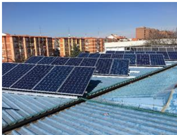
Ilustración 6: Instalación Fotovoltaica en cubierta inclinada. Fuente: (www.valladolid.es, 2022)
