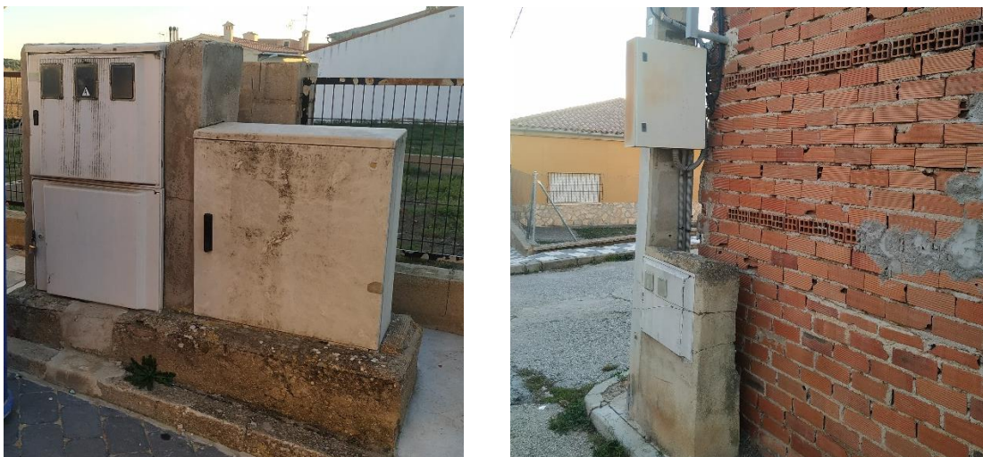
Ilustración 31: Cuadros de Alumbrado Público CMP 01 a la Izquierda y CMP 02 a la derecha. Fuente: (Elaboración Propia)
