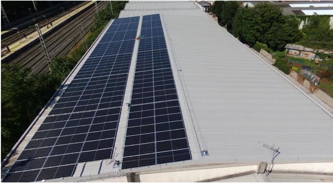
Ilustración 7: Instalación Fotovoltaica en la cubierta del Ferial, Ayuntamiento de Tolosa. Fuente: (www.fevymar.com, 2022)
