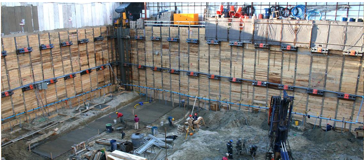
Figura 12: Muro berlinés en una obra de edificación en entorno urbano (Fuente: Catálogo de productos Pilotes Terratest)
