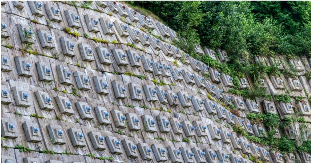
Figura 13: Muro anclado compuesto por anclajes activos (Fuente: Catálogo de productos de Retaining Walls NZ)
