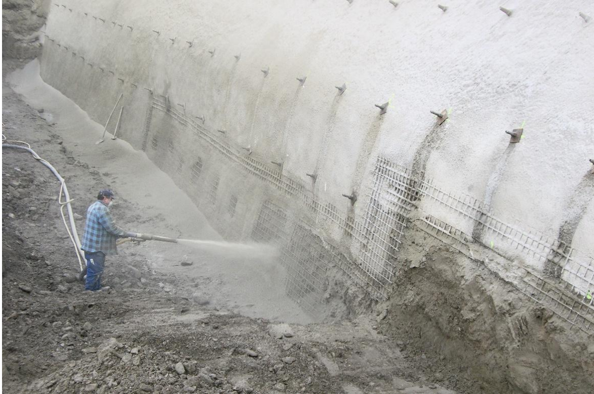
Figura 34: Figura 35: Operario proyectando hormigón sobre paramento armado con mallazo y previamente bulonado (Fuente: Slopes and Excavations – Design and Calculation (Wietek, 2022))
