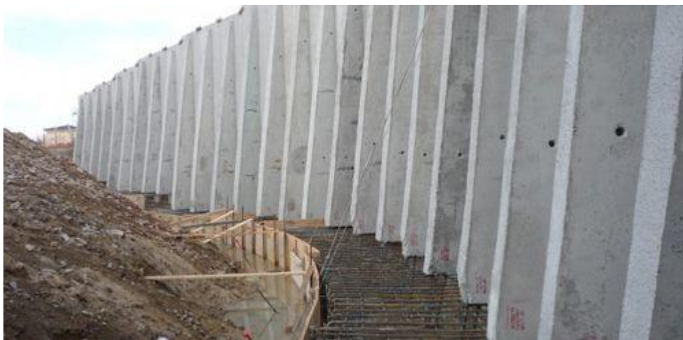
Figura 8: Encofrado y ferralla preparada para el hormigonado de la zapata de un muro de contención en voladizo con contrafuertes (Fuente: Catálogo de productos de Farcimar)
