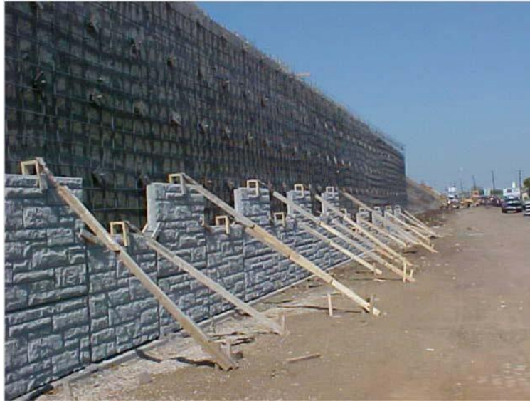
Figura 41: Ejemplo de revestimiento exterior con muro prefabricado (Fuente: Soil Nail Walls – Reference Manual (FHWA, 2015))
