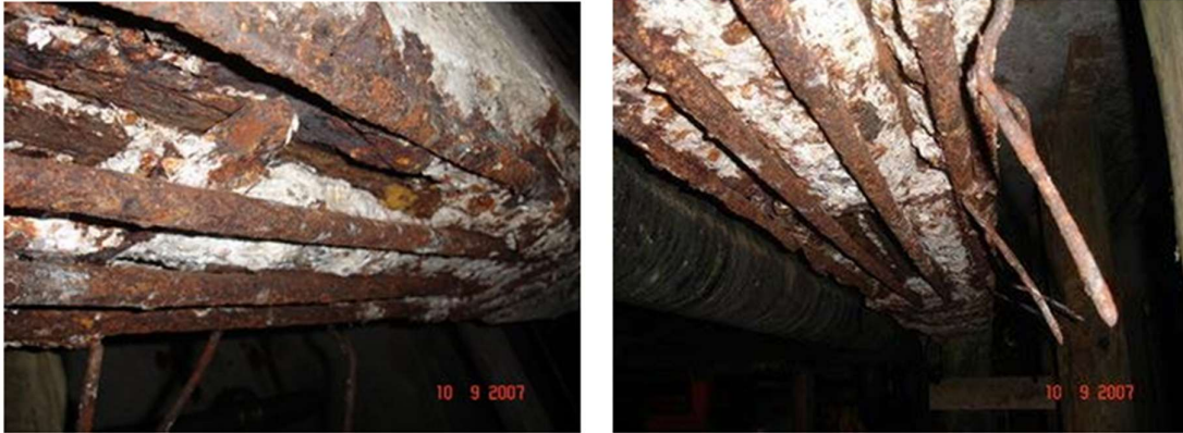
Figura 22 Corrosión severa en vigas con pérdida de recubrimiento (Peiren, 2007)
