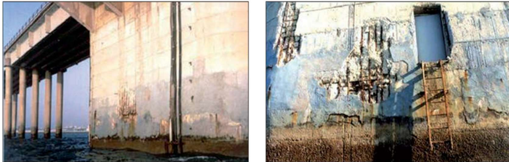
Figura 17 Efectos de la corrosión por cloruros en ambiente marino. (Dirección General de Carreteras, 2012)
