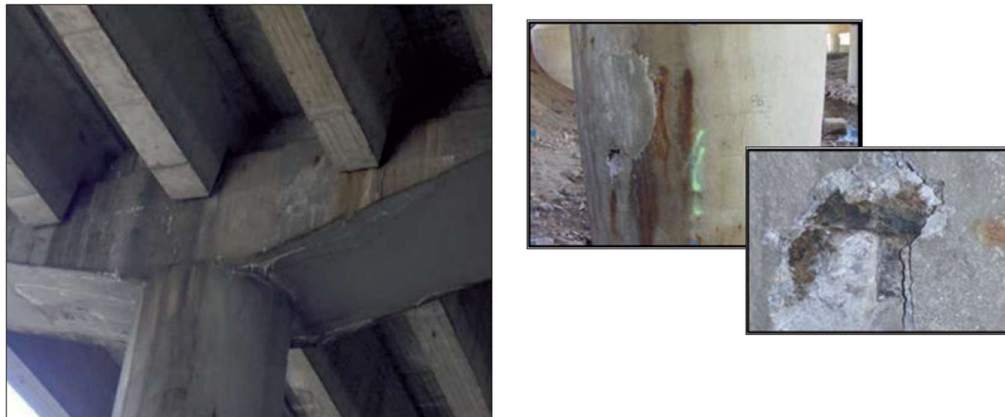
Figura 18 Efectos de la corrosión por cloruros en una pila con sales fundentes. (Dirección General de Carreteras, 2012)
