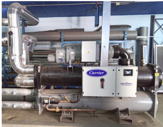
Figura 6 Una de las dos enfriadoras existentes y que se mantienen.
