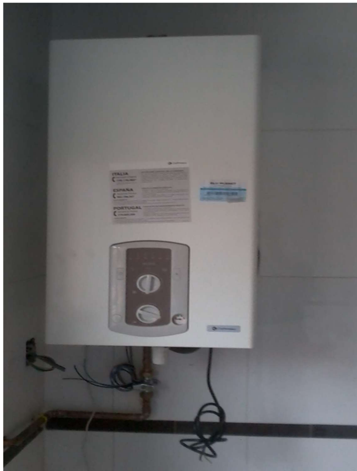
Figura 18. Caldera de gas convencional de la vivienda
