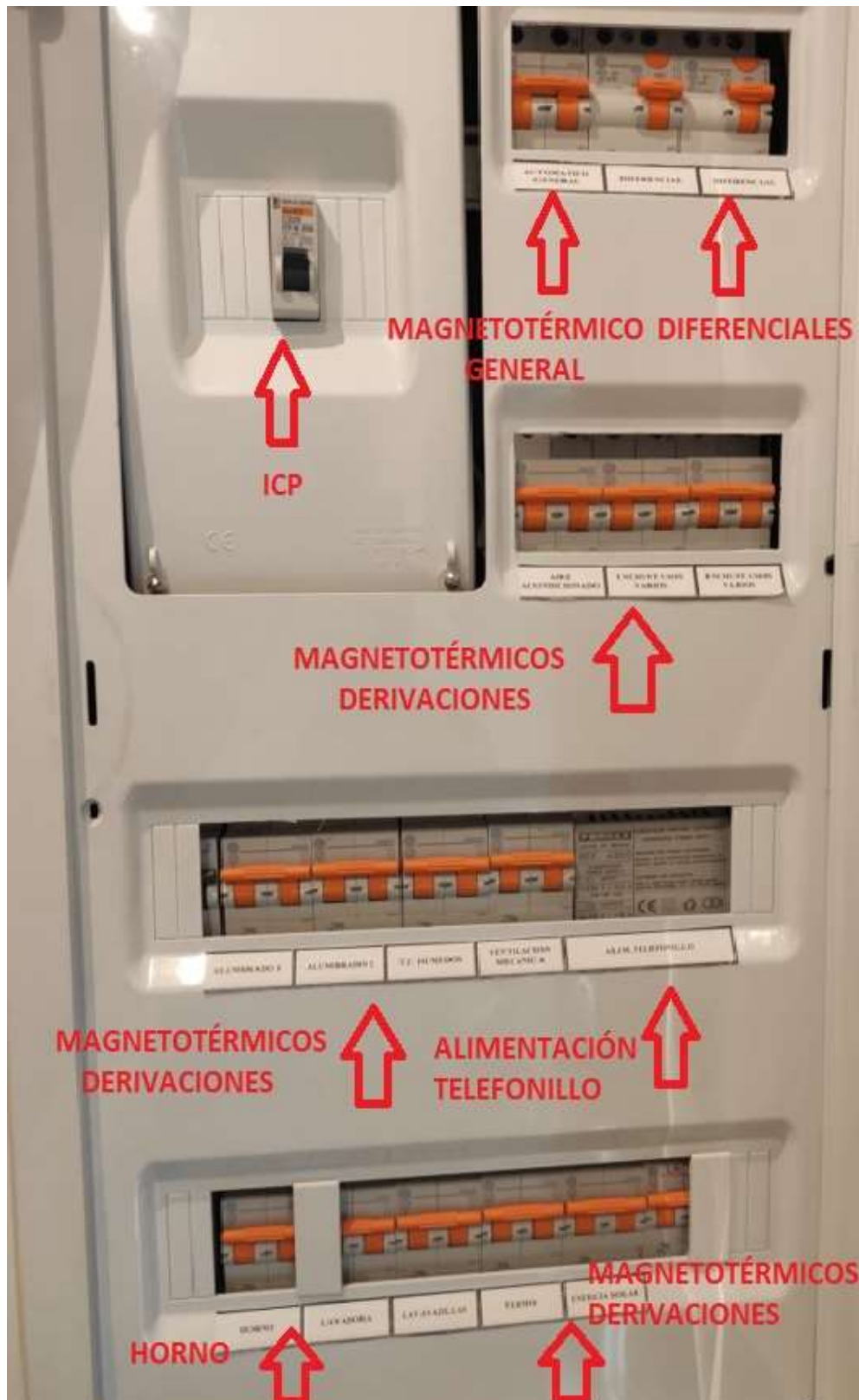
Imagen 26. Cuadro General de Distribución de la vivienda.
